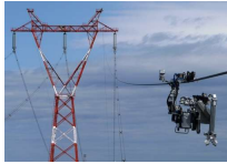
Travail au potentiel. Exemple de robot Linescout de Hydro-québec en service (sous tension)
