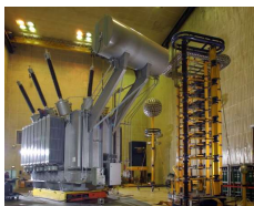
Transformateur en test
