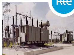
Transformateur en service
