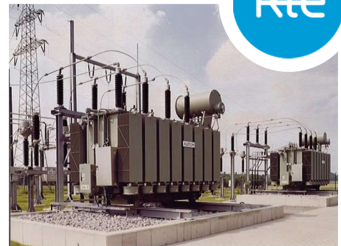
Transformateur en service
