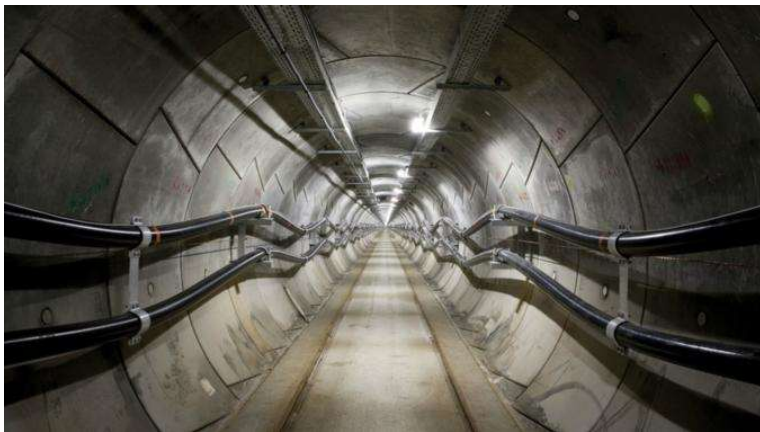
France-Espagne Nouvelle liaison souterraine 65Km – 2,8GW
