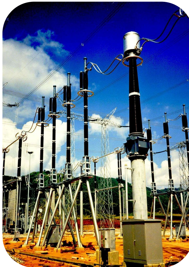
Disjoncteur 800 kV au Venezuela
