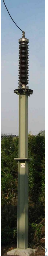
Parafoudre à varistance, Ligne 110 kV
