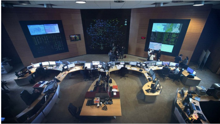
Centre de contrôle
