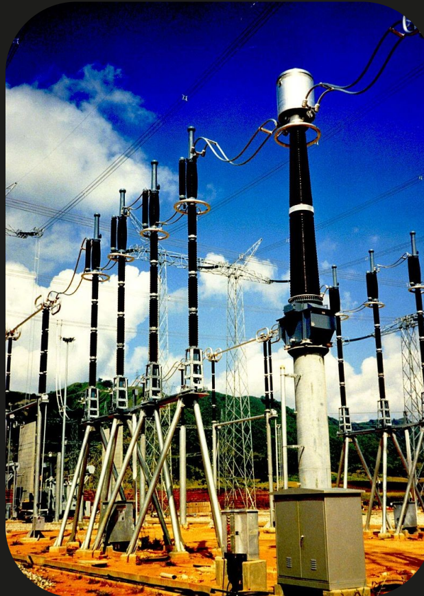
Disjoncteur 800 kV au Venezuela
